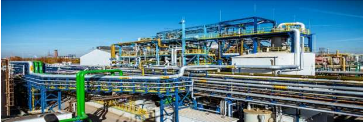
Instalacja elektrolizy membranowej, Segment Chloropochodne, Kompleks Chloru, fot. PCC Rokita
