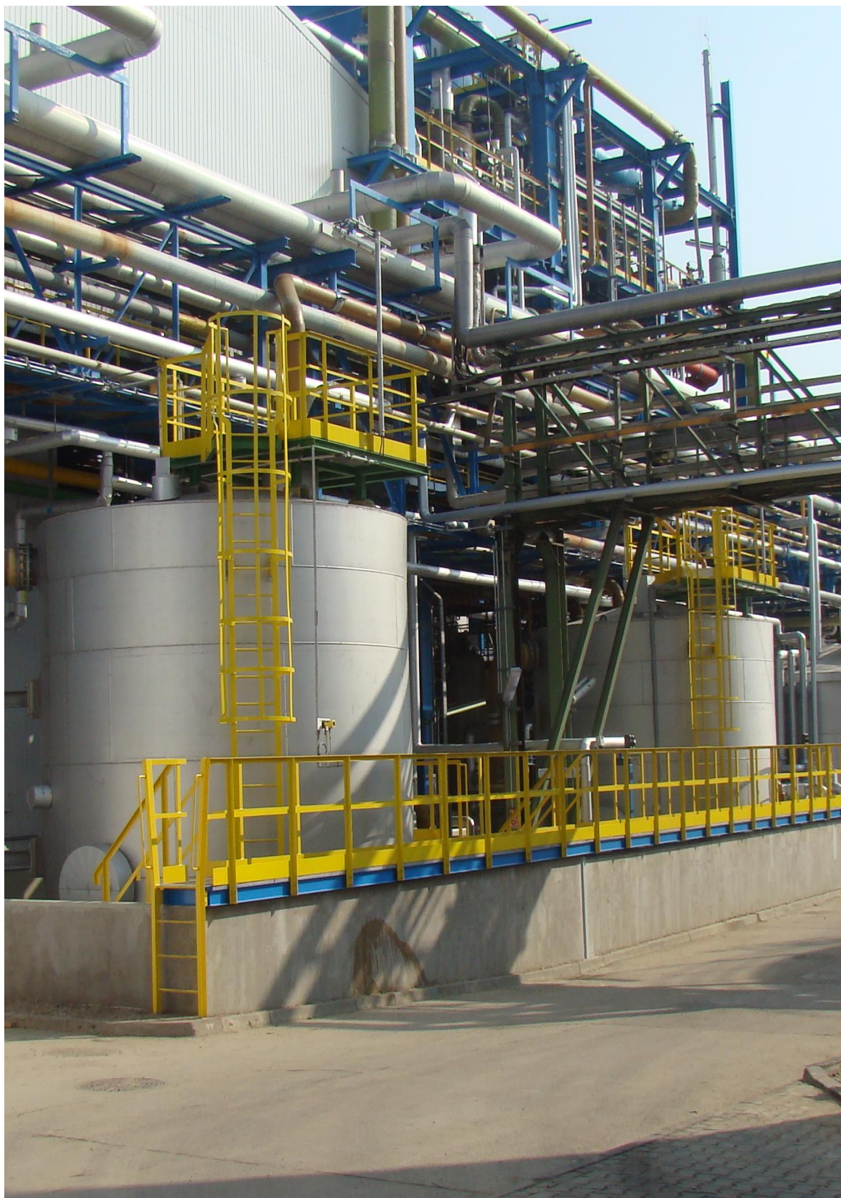
Kompleks Chlorowy Instalacja elektrolizy membranowej realizowana w części ze środków pozyskanych z emisji obligacji
