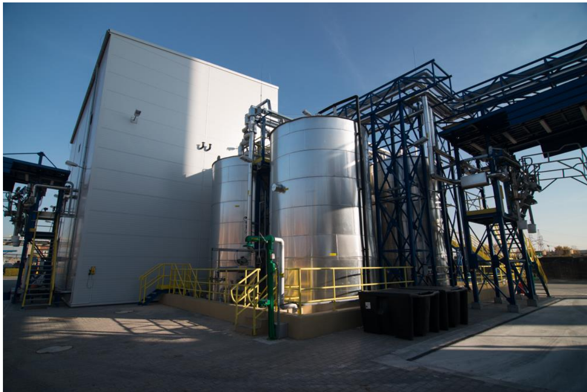
Instalacja betain w Brzegu Dolnym
