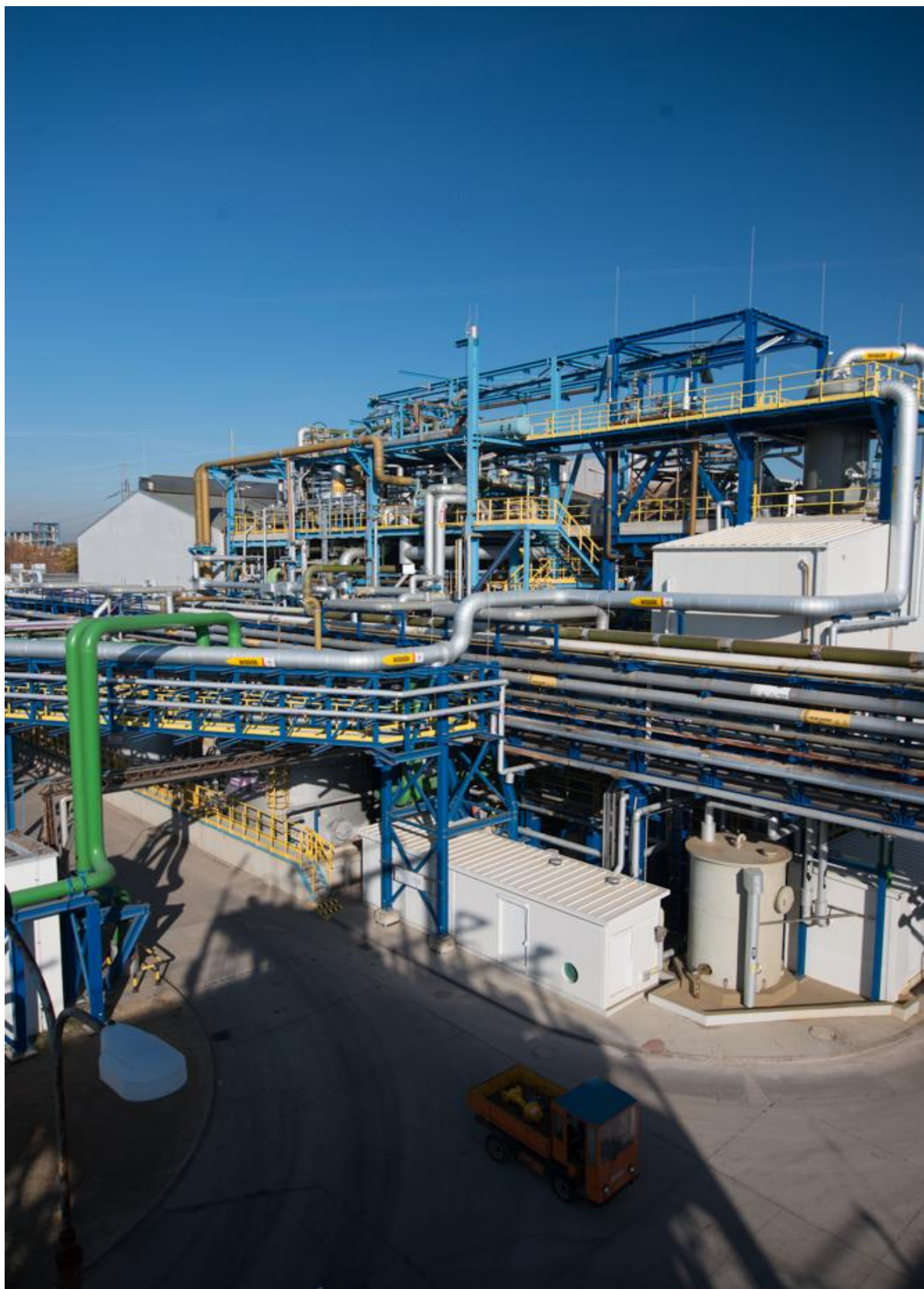
Kompleks Chlorowy Instalacja elektrolizy membranowej realizowana w części ze środków pozyskanych z emisji obligacji
