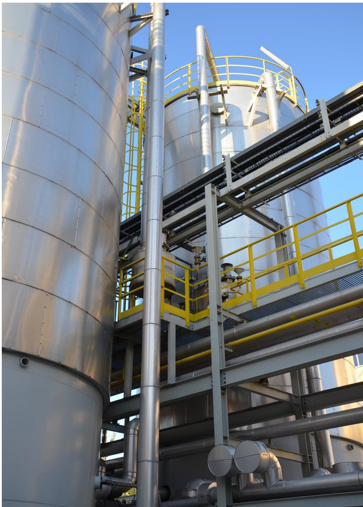
Instalacja Siarczanowane II w Brzegu Dolnym
