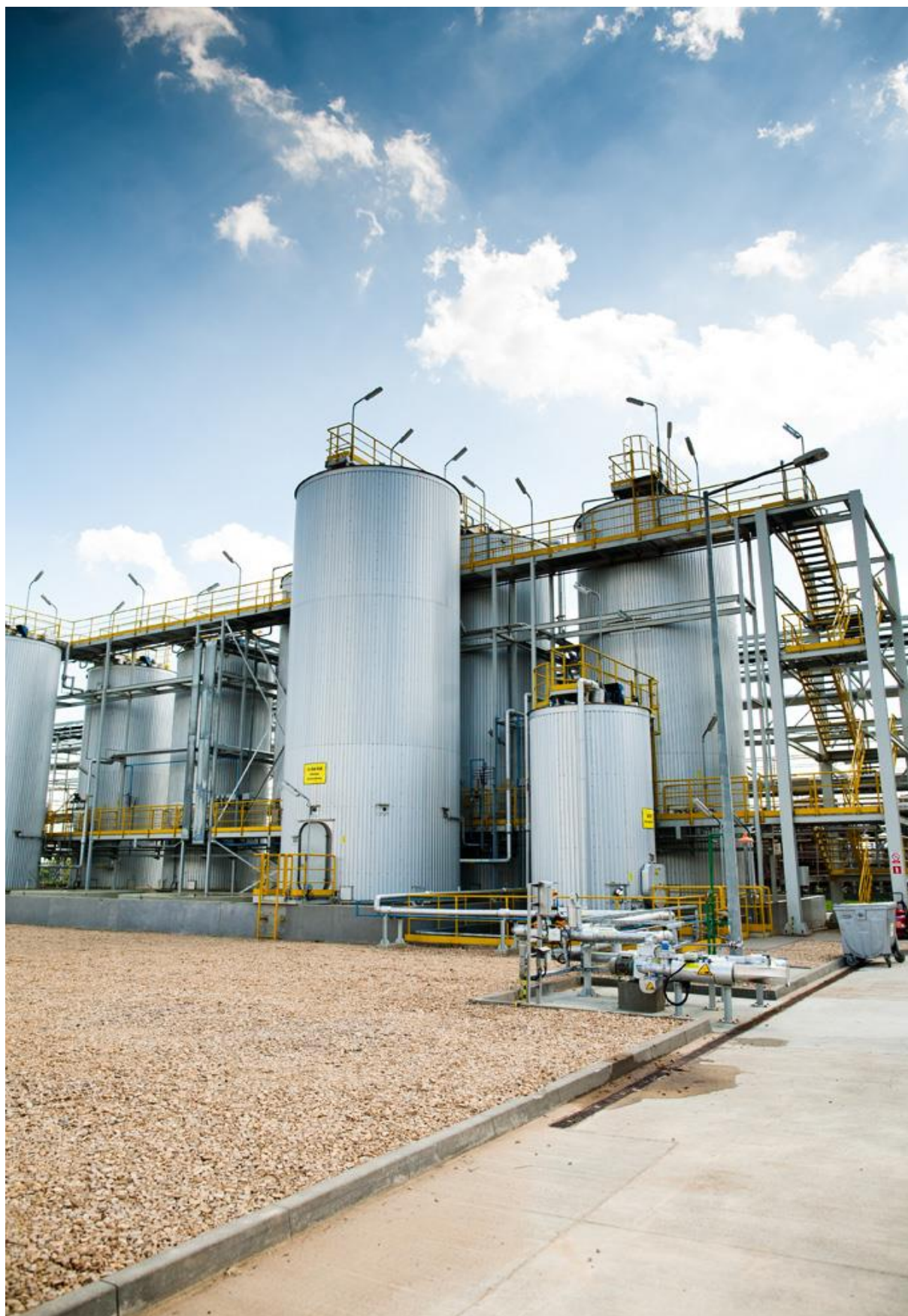
Instalacja Etoksylacji w Płocku
