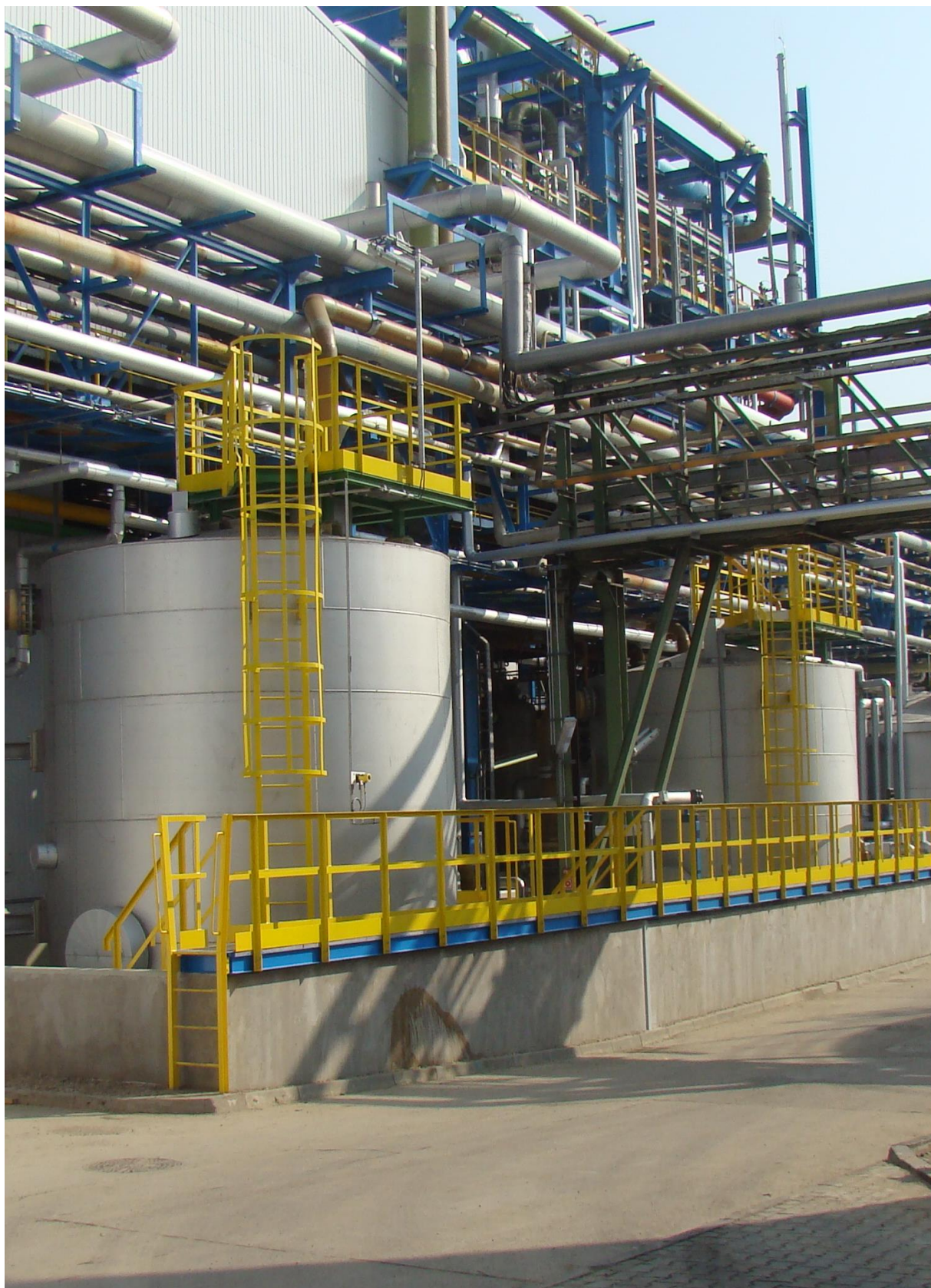
Kompleks Chlorowy Instalacja elektrolizy membranowej realizowana w części ze środków pozyskanych z emisji obligacji
