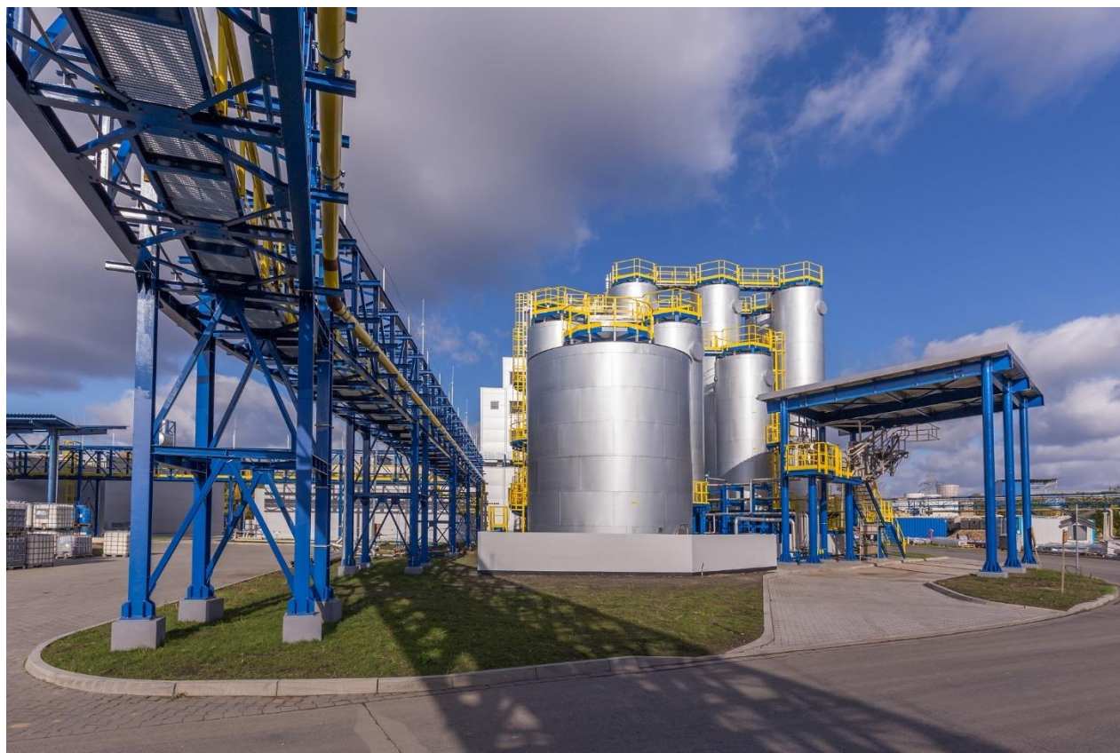
Instalacja do produkcji polioli poliestrowych, Segment Poliuretany, Kompleks Polioli, fot. PCC Rokita
